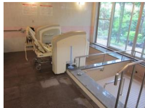
充実した設備の入浴施設
