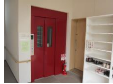
1階エレベーター
